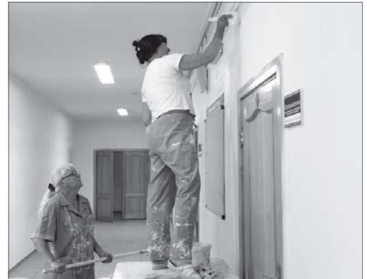
Косметический ремонт в учреждениях дополнительного образования сотрудники стараются выполнять сами. К более сложным работам привлекаются подрядные организации.
